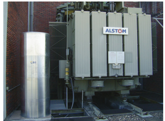
Bild 2 G3B-Installation am Industrietransformator
